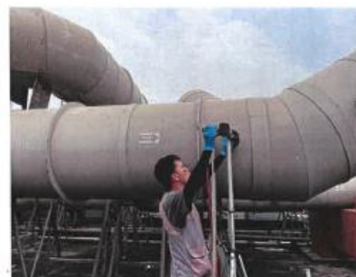
DA011废气处理前采样口
