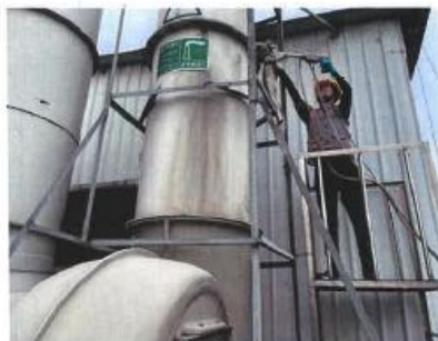
DA002废气处理后采样口
