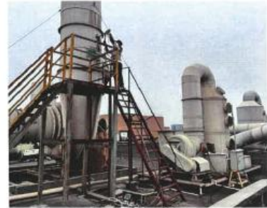
DA010废气处理后采样口
