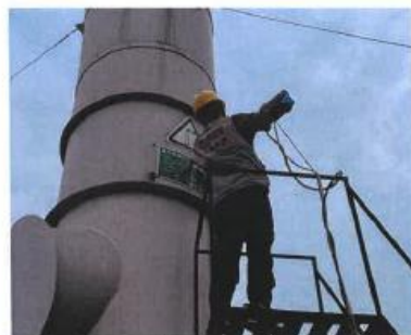
DA011废气处理后采样口
