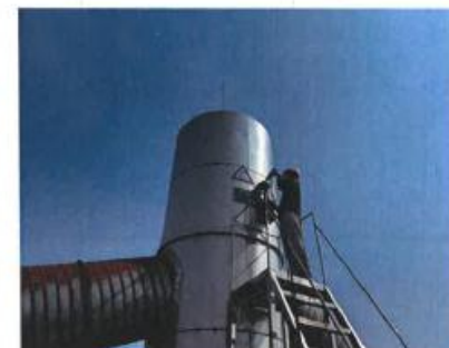
DA005废气处理后采样口
