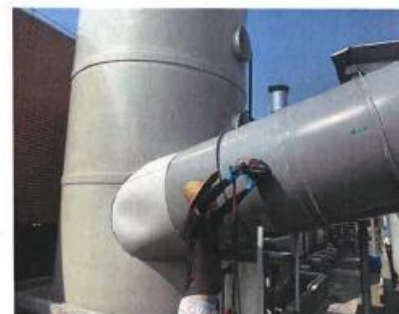
DA014废气处理前采样口
