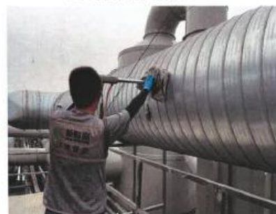
DA016废气处理后采样口
