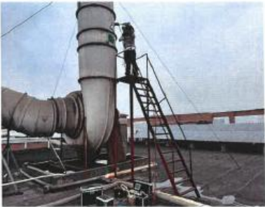
DA009废气处理后采样口
