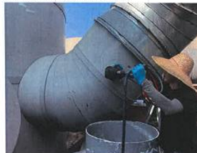
DA005废气处理前采样口
