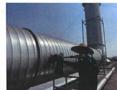
DA014废气处理后采样口
