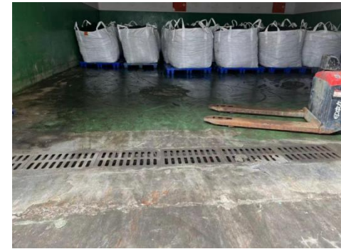
防泄漏收纳渠
