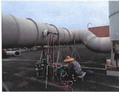
DA009废气处理前采样口
