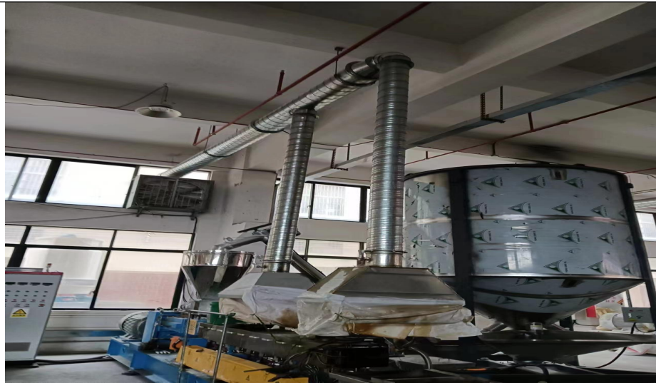
废气治理设施
