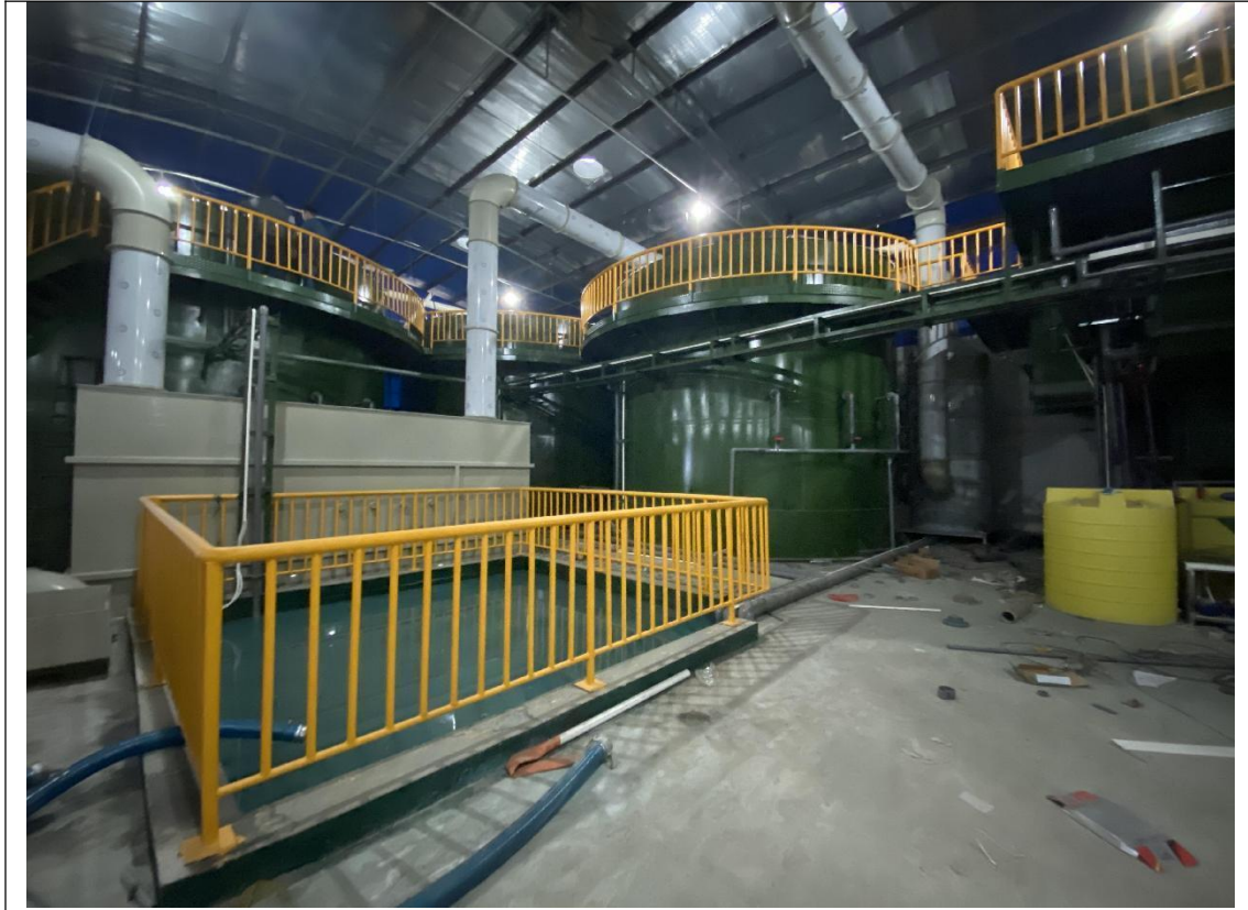
废水处理设施
