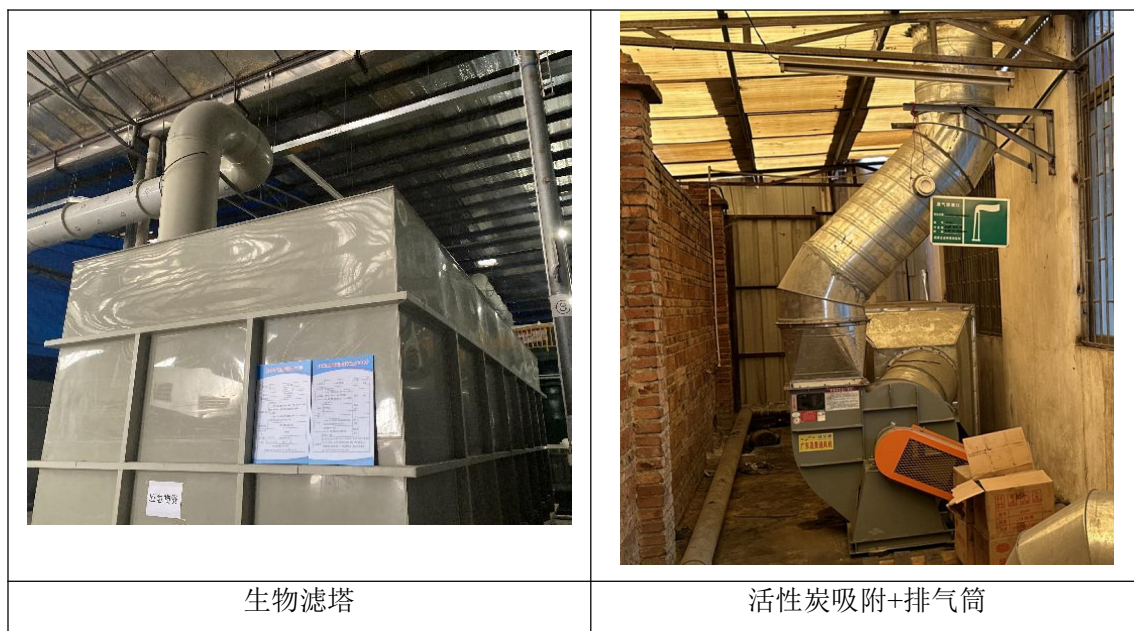
图 4.1-3 废气处理设施现场照片
