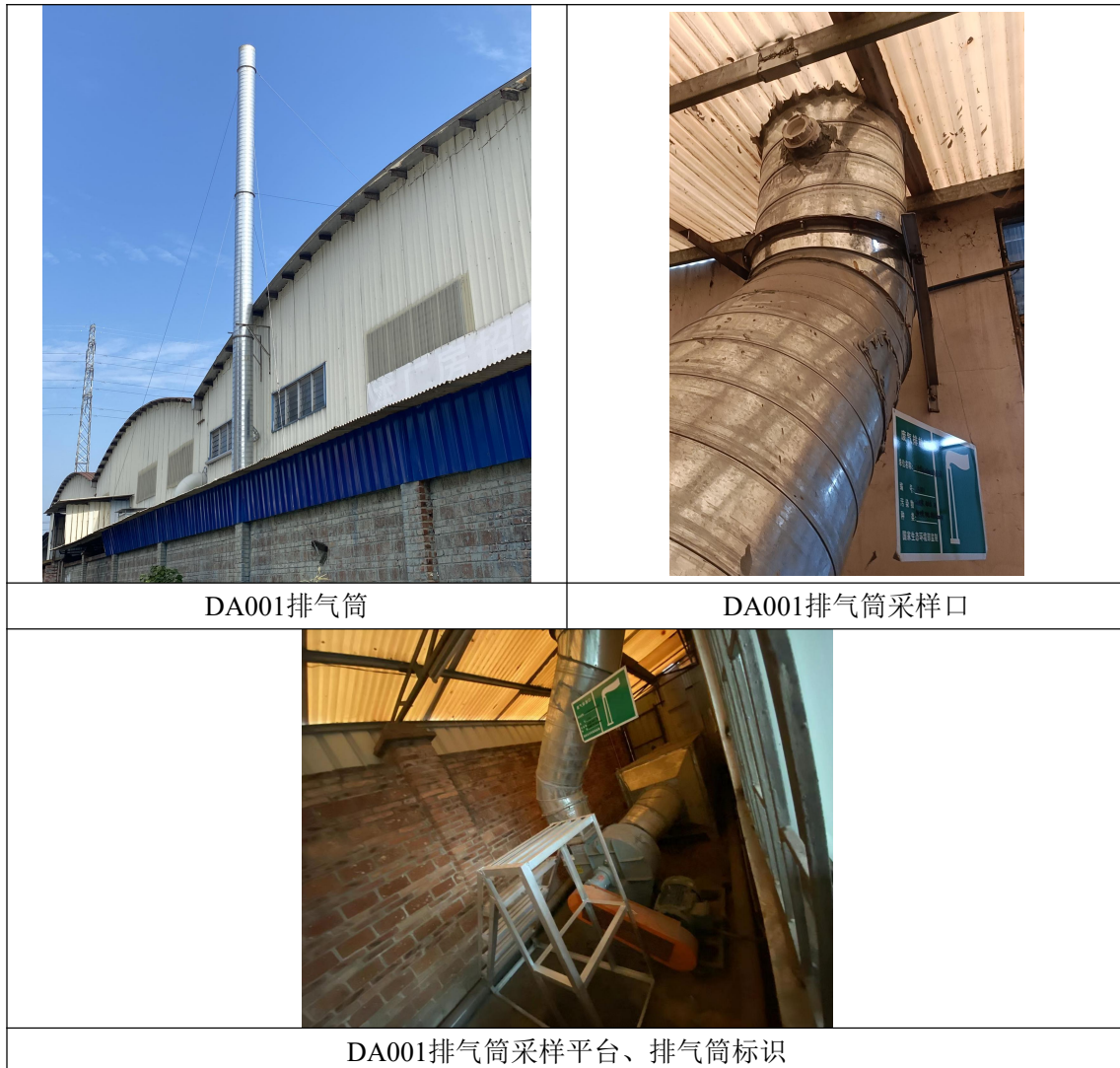
图 4.2-1 现场排放口、监测设施图片
