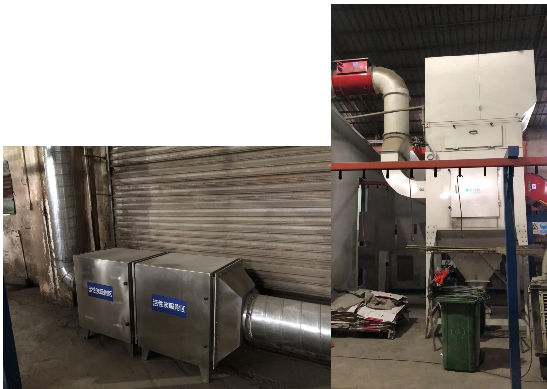
图 4-2 废气处理设施现场照片
