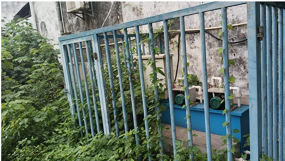
图 4-1 污水处理设施现场照片
