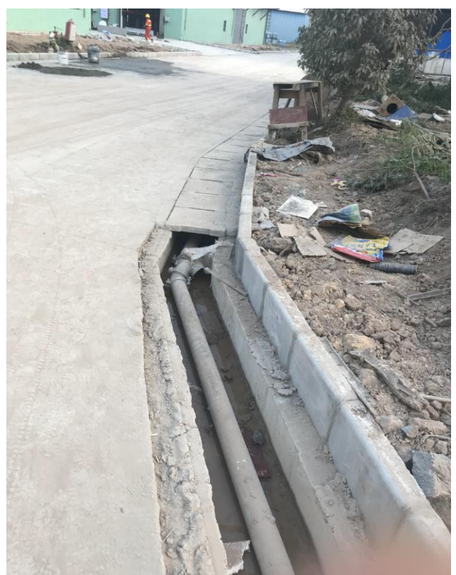
厂区雨污分流管网
