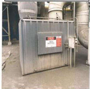
图5 一般固废暂存库备用废气处理设施
