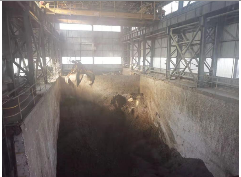
市政污泥暂存库内部
