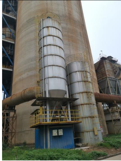
窑尾废气脱硫药剂储罐
