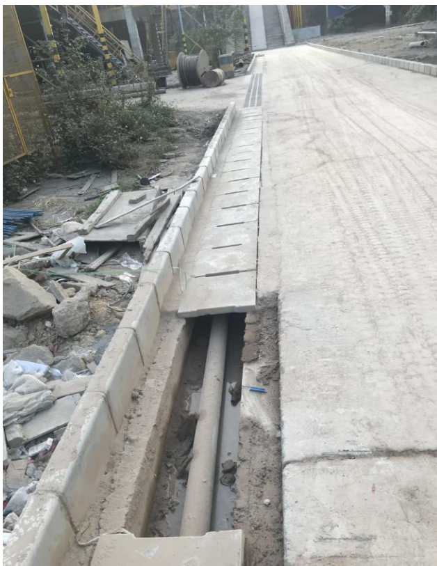
厂区雨污分流管网
