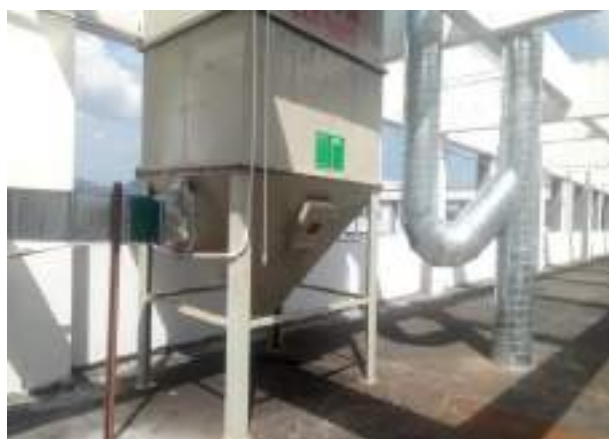
废气处理设施
