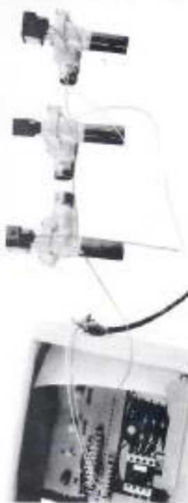
7. 接好后再通电源, 脉冲阀一个接一个接线柱, 公共线是串联起来接好。
